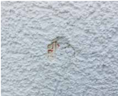
Mechanischer Schaden in der Fassade
